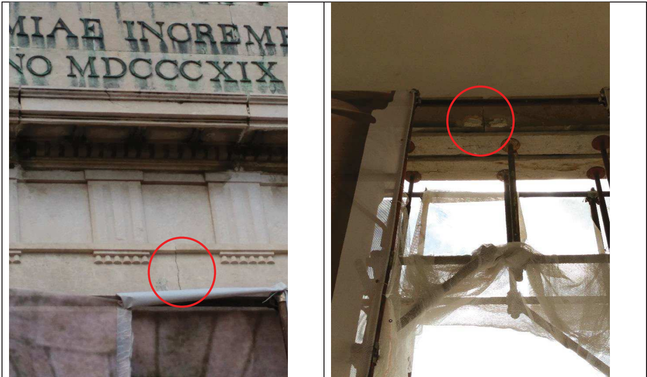
Figura 2: Fessura interessante l'architrave (fronte e retro)
